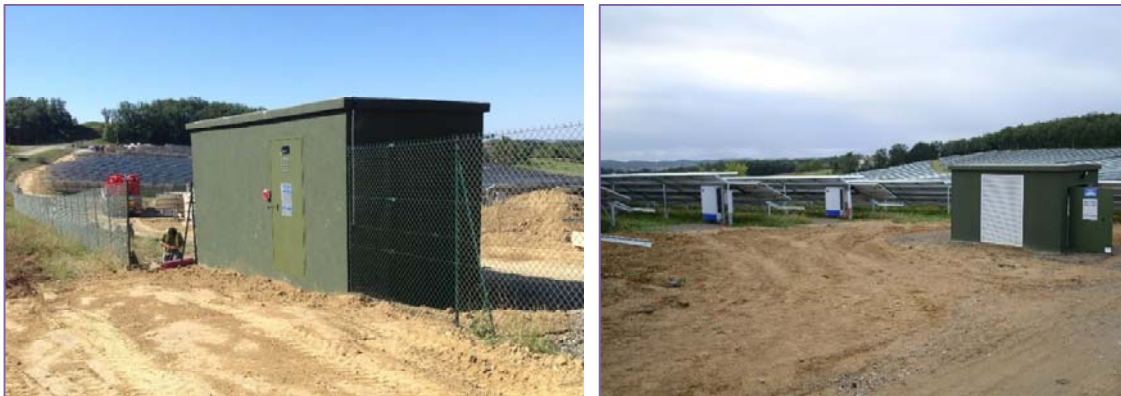
Exemples de poste de livraison et transformation de couleur verte
